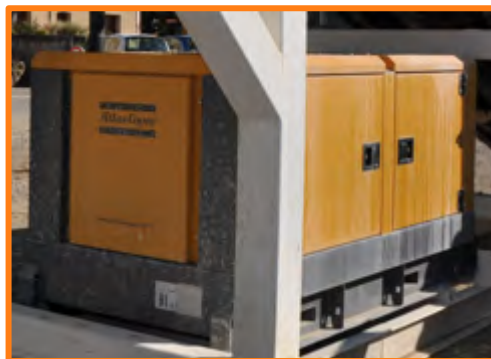
Groupe électrogène 25 KVA
