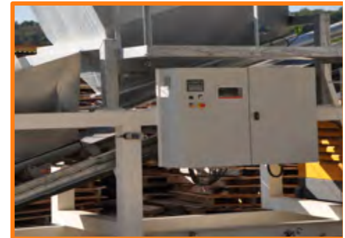
Armoire de puissance et pilotage
